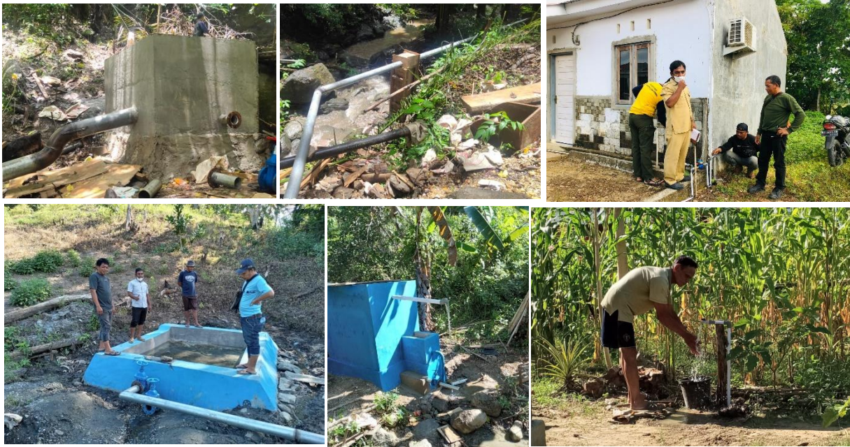
Gambar 3.8 Kegiatan peningkatan SPAM Jaringan Perpipaan di Desa Lantawonua dan di Desa Tembe
