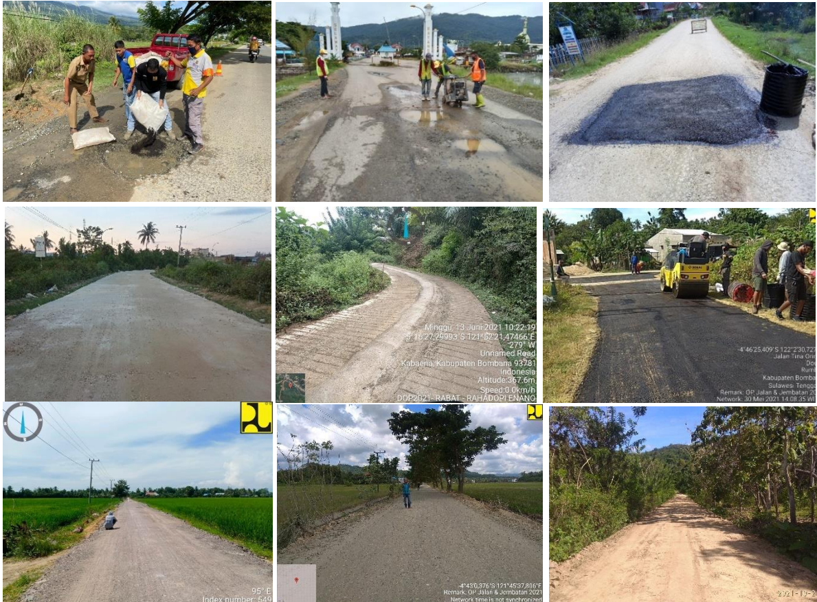
Gambar 3.2 Kegiatan pemeliharaan/rehabilitasi jalan kabupaten untuk pengembalian kondisi jalan dengan patcing asphalt, layering asphalt, dan perkerasan
